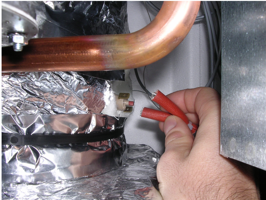
Figure 2 – Inspection du thermostat de sécurité du générateur
